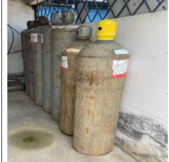
RECARGA DE CLORO GAS PARA LA DESINFECCIÓN
