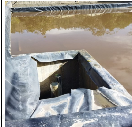
Filtros anaerobios de flujo descendente
