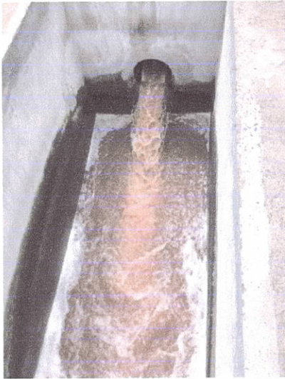
Entrada de aguas servidas
