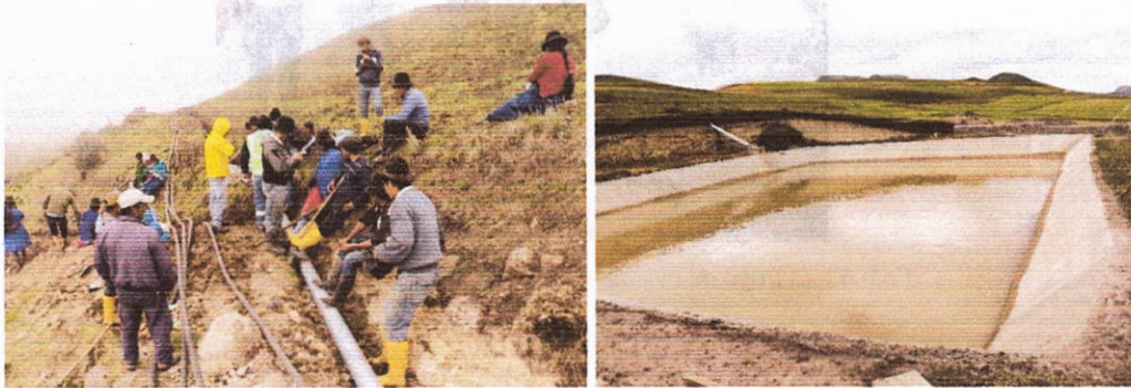
Foto 54. Sistema de Riego San Antonio
