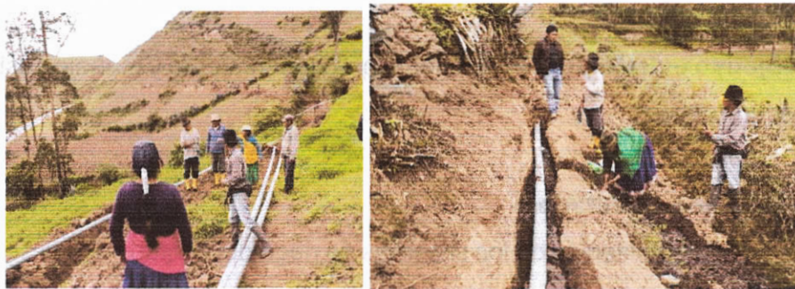
Foto 55. Sistema de Riego Nizag
