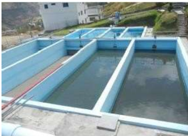
Imagen 45. Planta convencional de tratamiento presente en el cantón Alausí.
